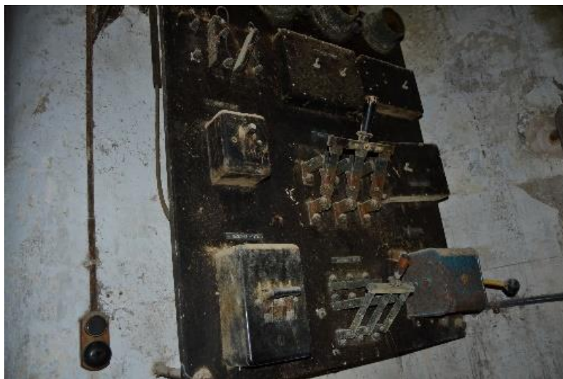
Cuadro eléctrico de la máquina antigua 150
