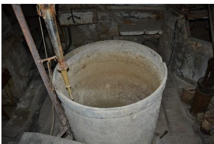
Depósito para productos químicos.
