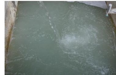
Depuradora. Agua tratada
